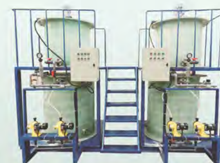
循环水加药装置
